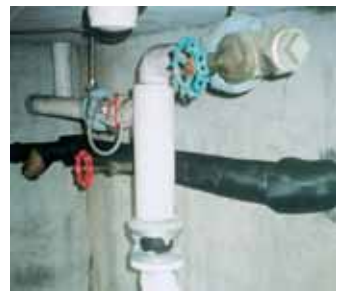
ポンプ室の中
