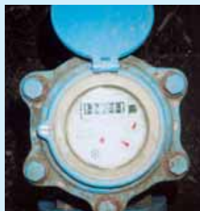
水道メーター
