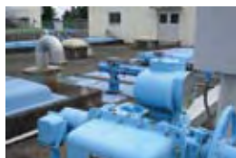
活性炭せつしよく池
