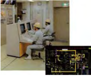
中央せいぎょ室 機械の運転の様子を せいぎょしています。
