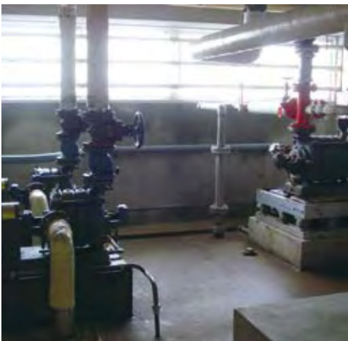
ポンプ室の中
