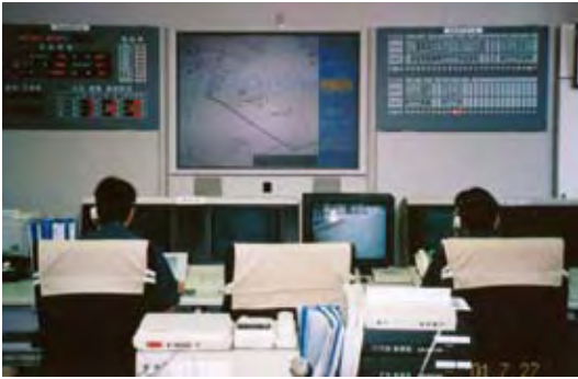
通信指令室の中
