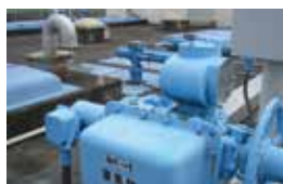
活性炭せつしよく池
