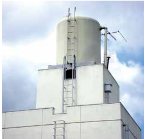
屋上の給水タンク
