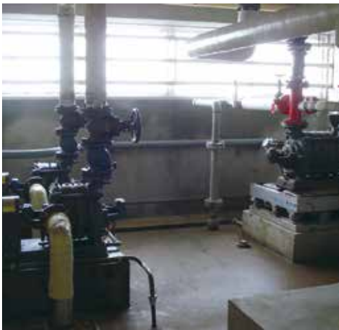
ポンプ室の中
