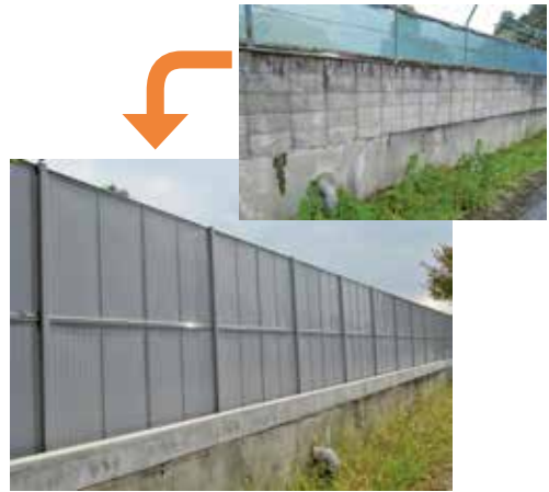
工事でおれにくくなったへい
